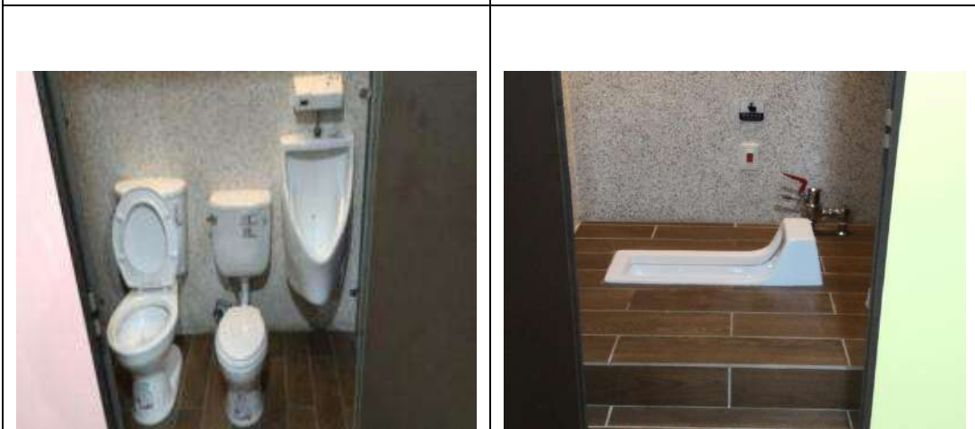
圖 13-3 針對不同使用於不同廁間設置不同便器。(來源：內政部建築研究所，104)
